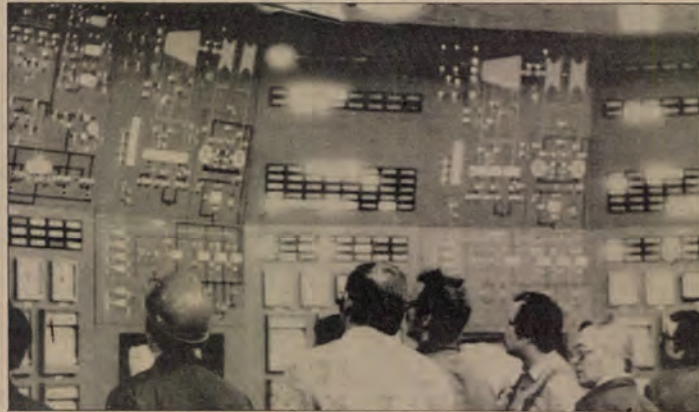
A képen az egyes blokkvezénylő, ahonnan a bekapcsolási műveletet irányították
